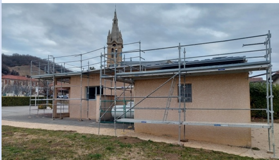
La salle des fêtes de Chasselay, prête à recevoir ses panneaux solaires. Les échafaudages sont déjà en place.
